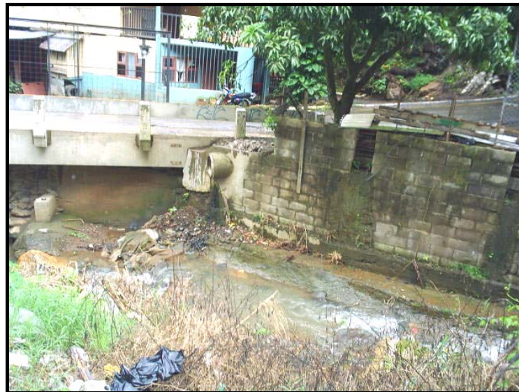
Ilustración 3.28: Casas de Habitación Prácticamente sobre Cauce de Río Oro en Barrio España. Los Desechos Sólidos son Visibles así como la Llegada de Alcantarillas que Desaguan sobre este río. 02 – octubre - 2005
