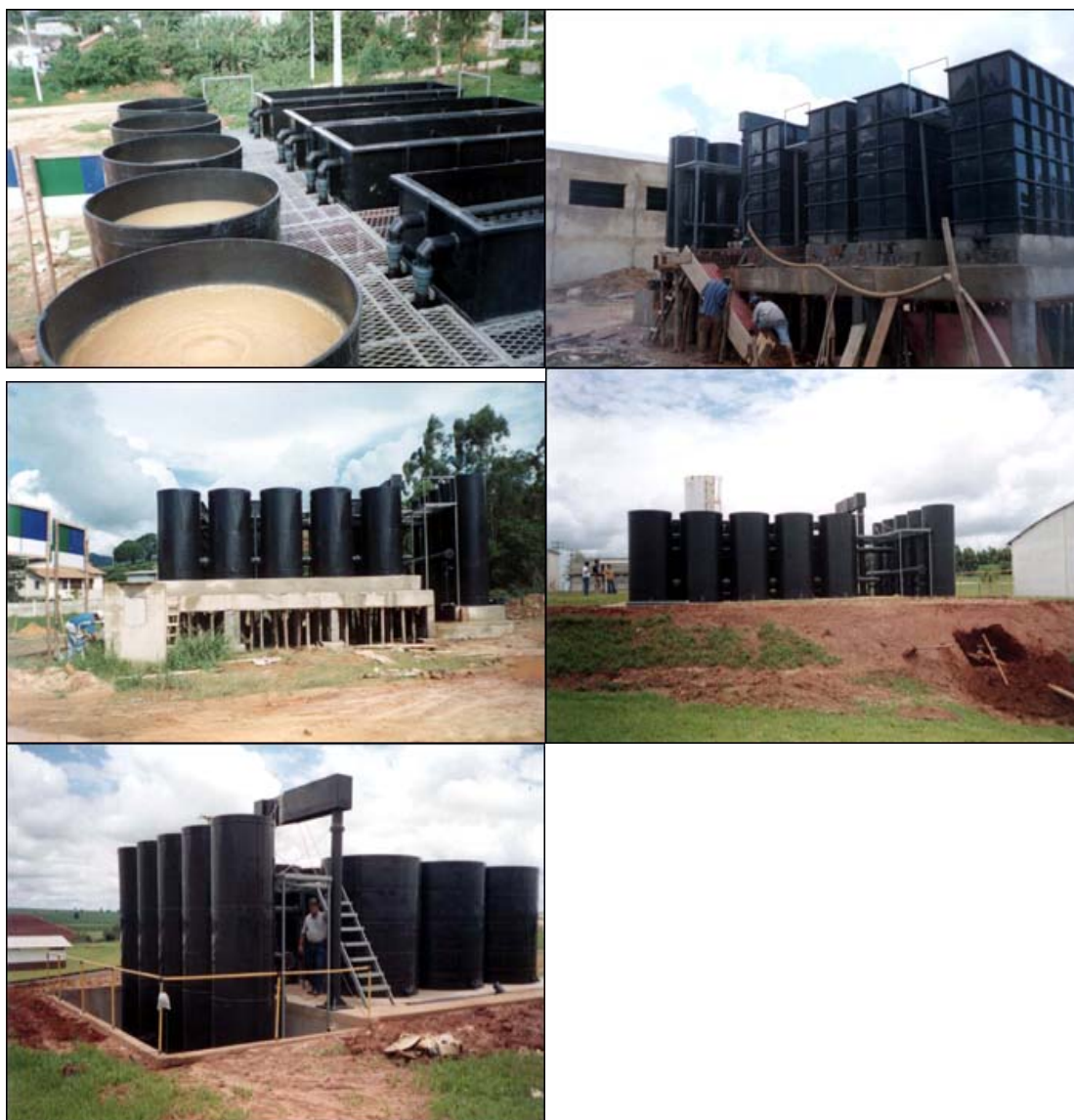
Figura 1. Estação de Tratamento Modular de Polipropileno.
