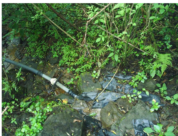
Ilustración 5.10. Captación de Agua
