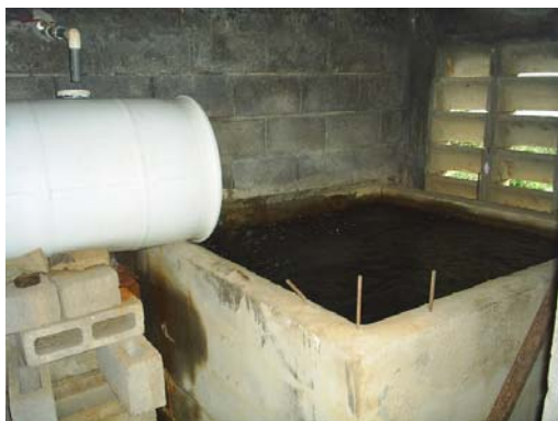
Ilustración 5.14 sistema de cloración del acueducto Los Montoya.
